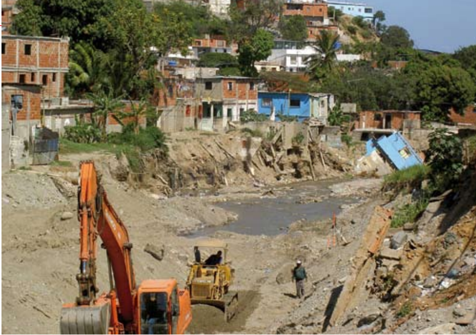
• Häftiga skyfall och skred ställer till total förödelse längs de tätbefolkade smala kustremsorna. Det pågående EU-projektet syftar till att förebygga och mildra effekterna av naturkatastroferna.
