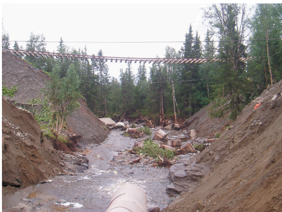
Järnvägsrälsen hänger fritt över Klockbäcken sedan vattnet spolat bort järnvägsbanken.
