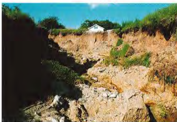
Kraftig erosion i en ängssluttning vid Boxvik nära Nösund
